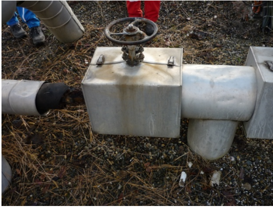
Figure 2 : Photographie de l'état de vétusté du réseau incendie
